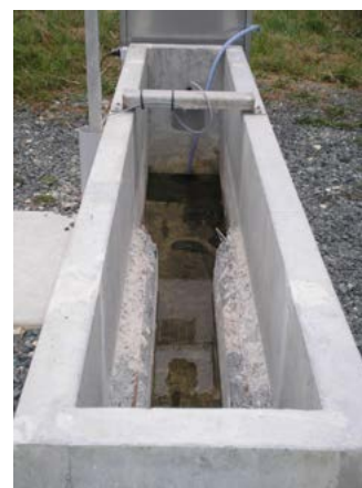
Canal de mesure de débit
